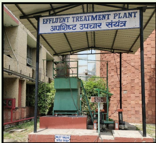
Effluent Treatment Plants (ETP)
